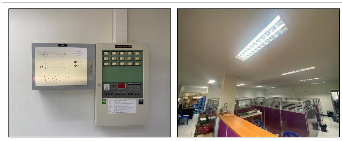
ภาพที่ 3.14 ภาพถ่ายระบบแจ้งเหตุเพลิงไหม้และระบบไฟฟ้าส่องสว่าง
